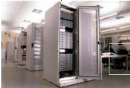
Rechnerraum im Forschungszentrum Karlsruhe
