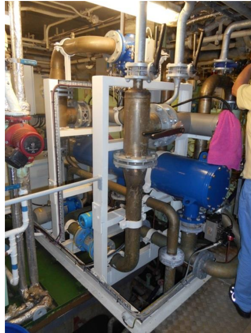
Abb.: 2 Ballastwasserbehandlungsanlage von Meteor
